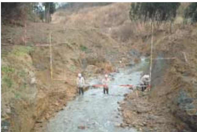
写真－5 被災した護岸の測量
