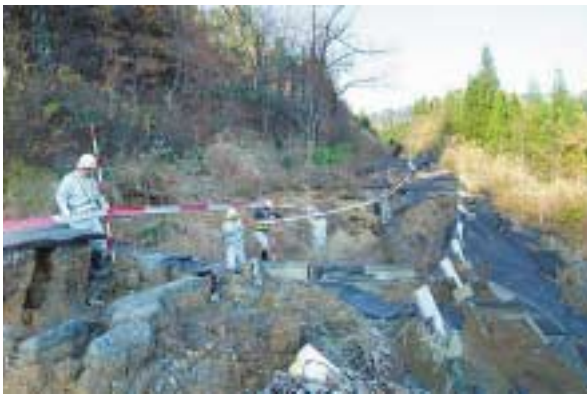
写真－3 道路路肩崩落
