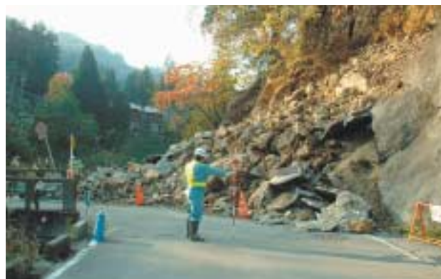
写真－1 崩落により道路不通
